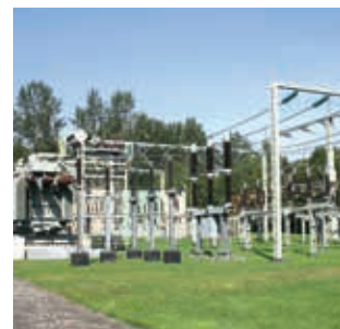
Umspannanlage an der Bachstraße in Erkrath
