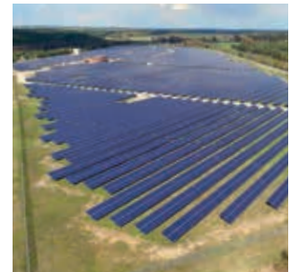
Photovoltaik-Freiflächenanlage der Trianel Erneuerbare Energien GmbH & Co. KG
