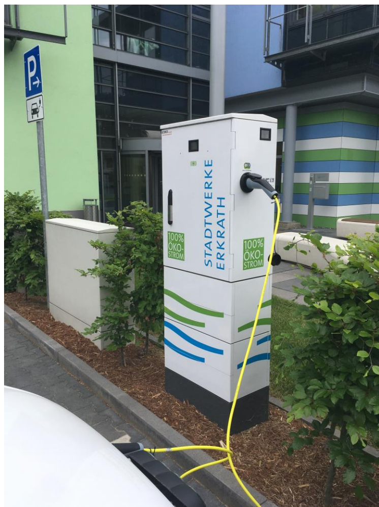
Bildunterschrift: E-Ladesäule vor dem Gebäude der Stadtwerke Erkrath
