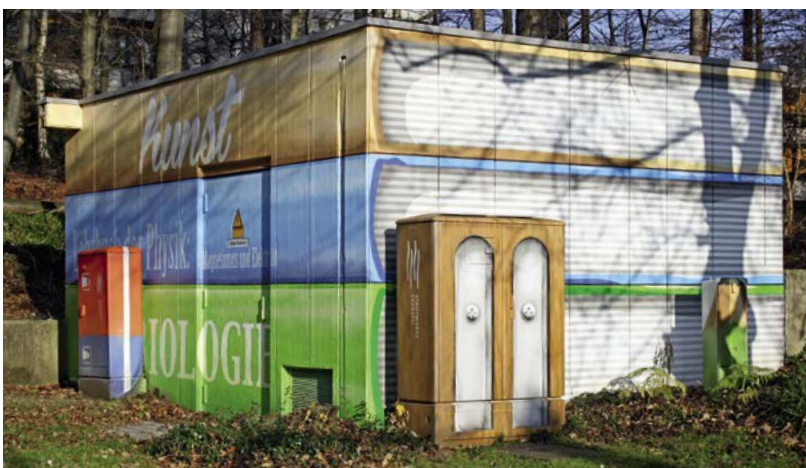
Die Trafostation an der Rankestraße – ein echter Hingucker: Schulbücher, Radiergummi und Spitzer verschönern jetzt den Schulweg.
