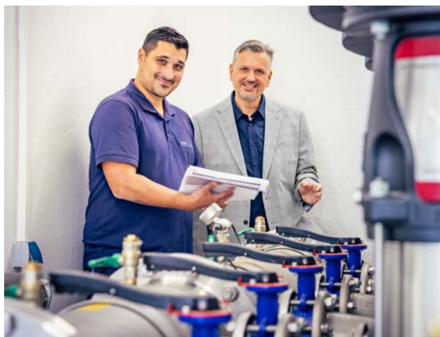
Dirk Pohlig und Monteur Stephan Hodi in der neuen Druckerhöhungsanlage, welche erst Mitte August feierlich eröffnet wurde.
